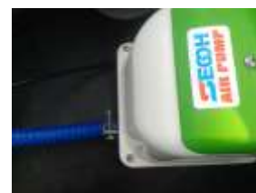
Fig-32 : Raccordement côté surpresseur
