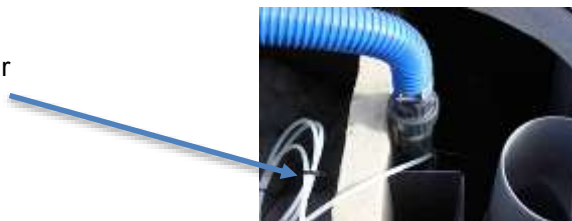
Fig-11 : Contrôle du tuyau d'amenée d'air
