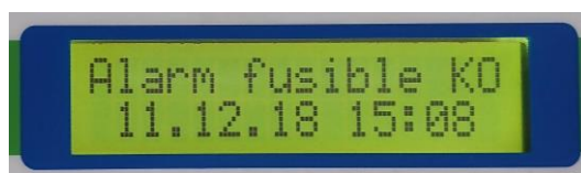
Fig-49 : Ecran « Alarm fusible KO»
