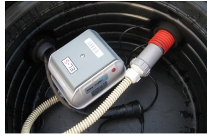
Fig-19 : raccordement électrique en local technique
